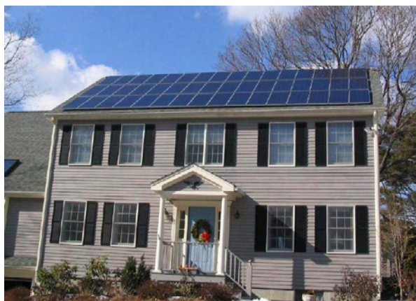
Figura 33: Vivienda con paneles fotovoltaicos
